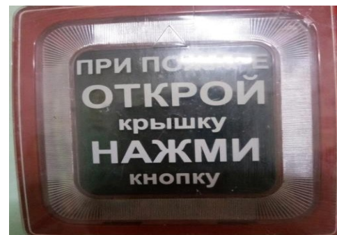
Фото № 14. Визуальное средство оповещения о пожаре
